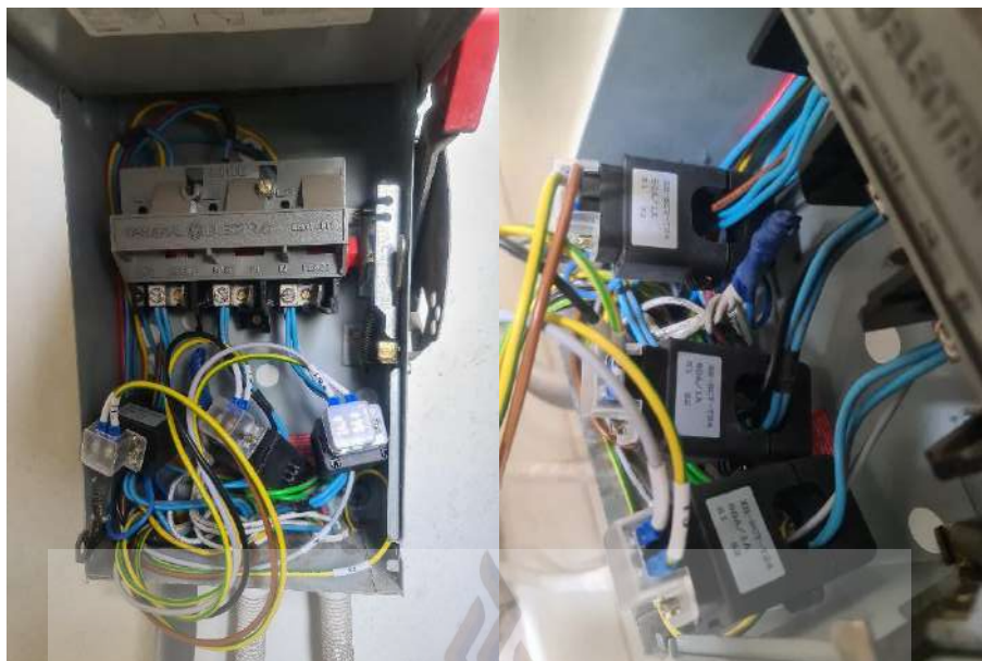
รูปที่ 4.11 การออกแบบและติดตั้งอุปกรณ์ตรวจวัดพลังงาน ดิจิตอลมิเตอร์แบบ 3 เฟสต่อกับเครื่องมือวัดกำลังไฟฟ้า
