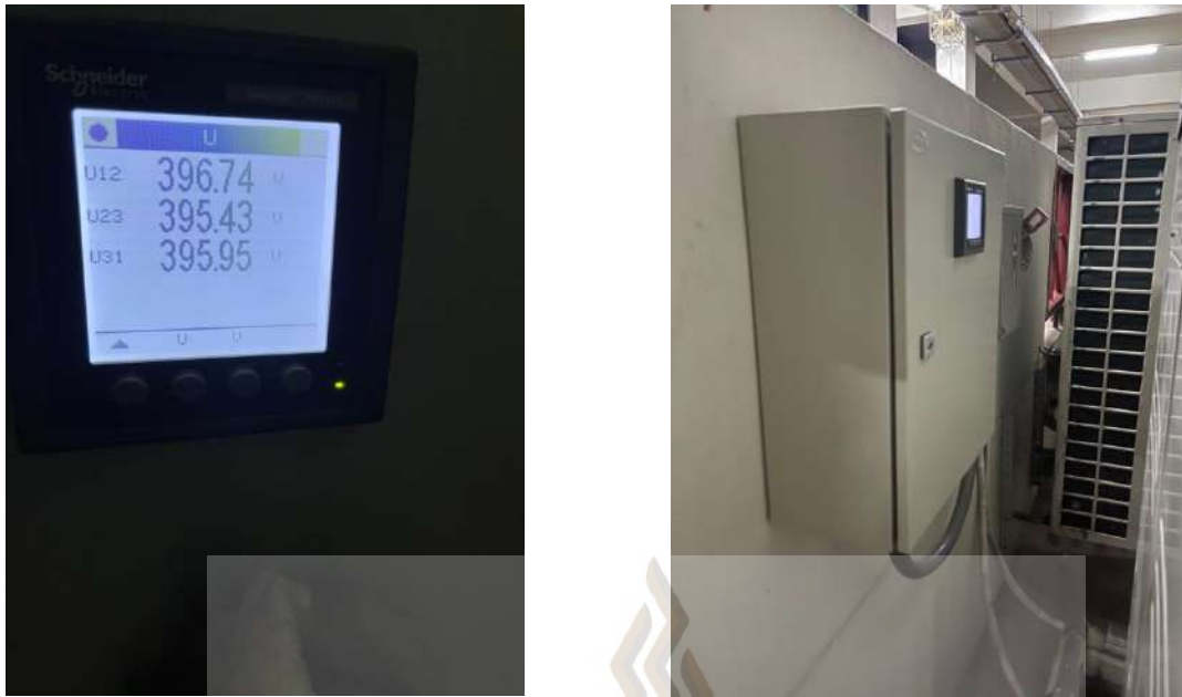
รูปที่ 3.28 การตรวจสอบการทำงานของตู้ระบบชุดส่งสัญญาณการเชื่อมต่ออัตโนมัติและเชื่อมต่อกับระบบจัดการพลังงาน
