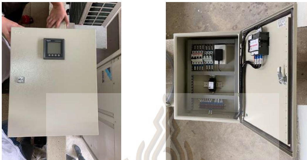
รูปที่ 3.24 ตู้ระบบชุดส่งสัญญาณการเชื่อมต่ออัตโนมัติและเชื่อมต่อระบบจัดการพลังงานติดตั้งเข้ากับเครื่องปรับอากาศแบบควบคุมปริมาณการจ่ายสารทำความเย็นแปรผัน
