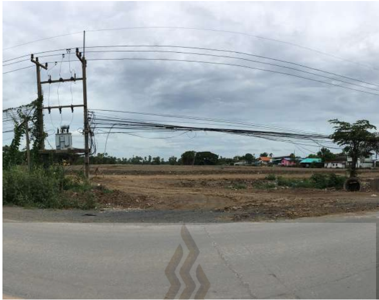
ภาพที่ 4.16 การถมที่ดินเพื่อเตรียมการก่อสร้าง บริเวณตำบลบ้านกลาง อำเภอเมืองปทุมธานี
